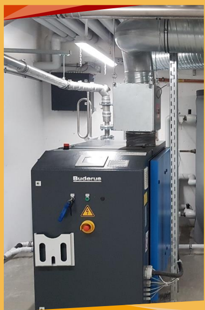
Blockheizkraftwerk im Mehrgenerationenhaus
