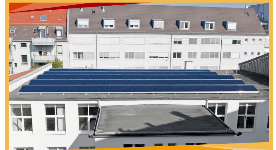
PV-Anlage auf dem Dach des FZI House of Living Labs
