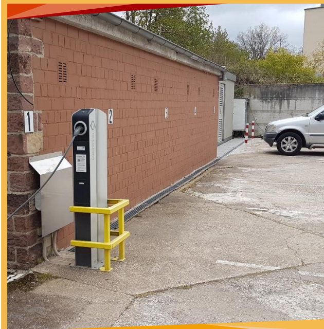
Ladestation auf dem Hoepfner Gelände
